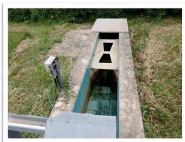
Canal de rejet – Steu de Marguerittes
